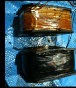
焼損したコイル
